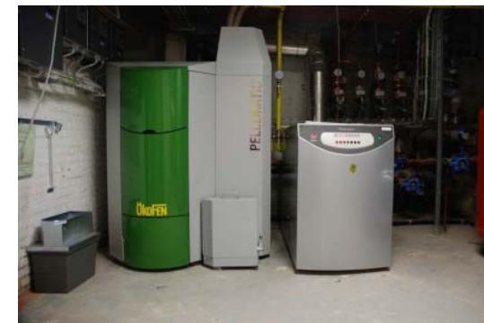
Chaufferie à Mundo-B (Bruxelles) : chaudière à pellets(gauche) et chaudière gaz à condensation (droite)
